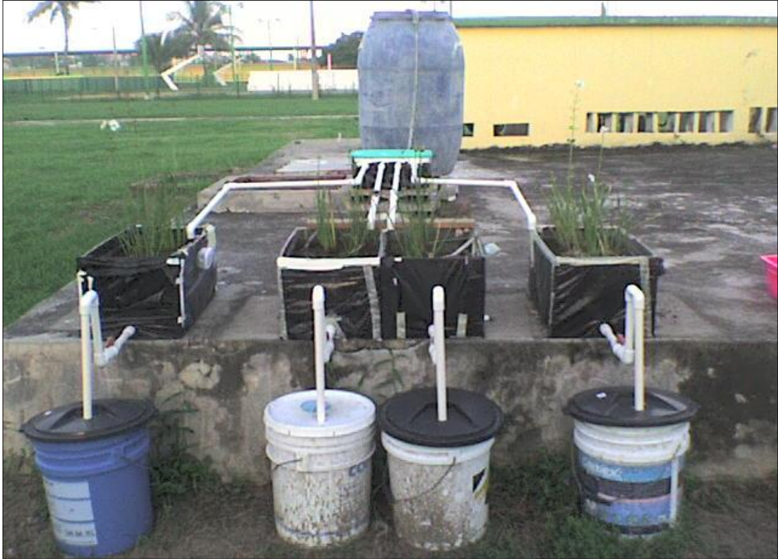
Figura 19. Fotografía del sistema de distribución de flujo y humedales artificiales construidos.
